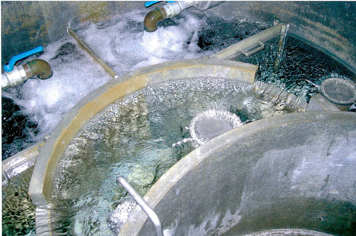
74 Brunnenstube mit Quelleinläufen, Beruhigungsbecken, Überlaufstutzen, Trinkwasserseihier und Trockeneinstieg (Vordergrund), Januar 2008. Foto: ALU
