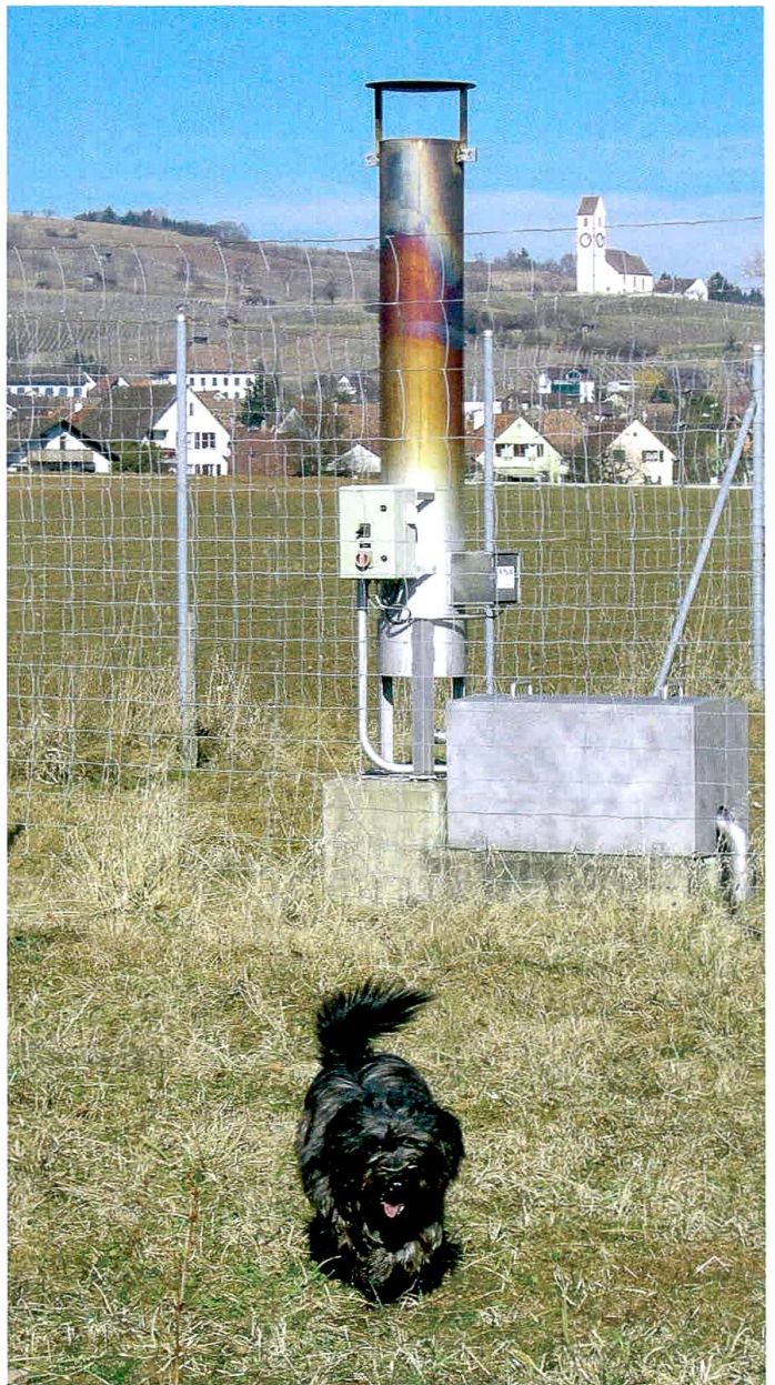
95 ARA Hallau, Gasfackel. Foto: ALU
