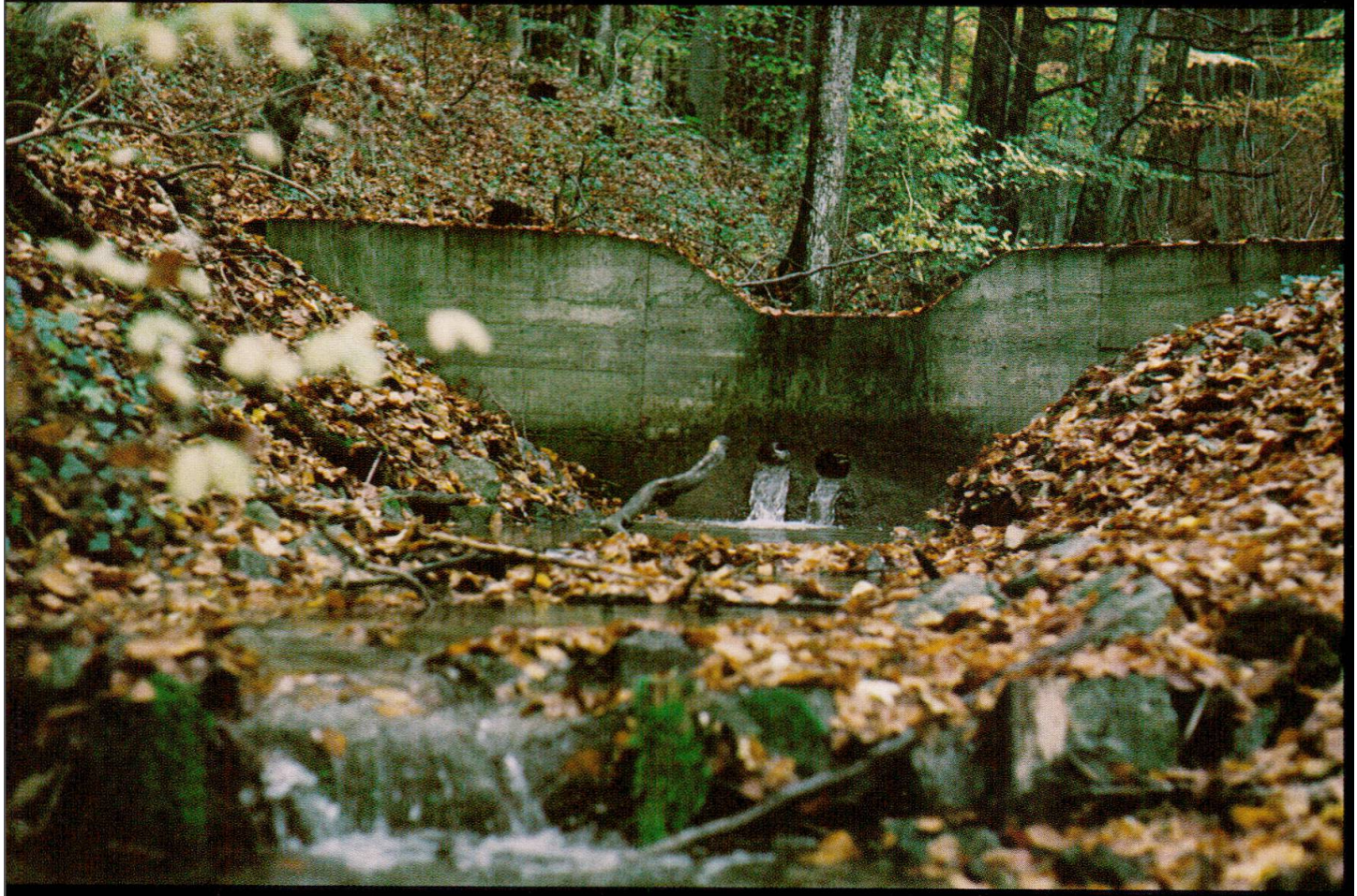
Abb. 10 Brutale Betonsperre im Mülital
