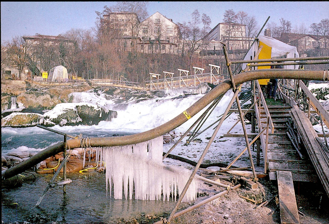
Abb. 16 Spritzbetontransportleitung vom Neuhauser Ufer aus
