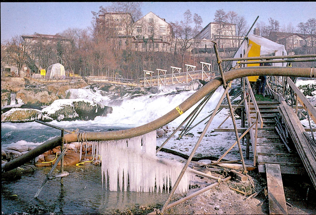
Abb. 16 Spritzbetontransportleitung vom Neuhauser Ufer aus
