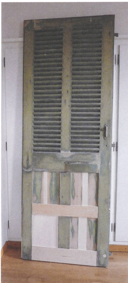
Heute werden defekte Bauteile in der Regel ganz ersetzt, auch wenn sie nur einen reparierfähigen Schaden aufweisen. Seltenes Beispiel für eine Reparatur eines hölzernen Klappladens. © Eva Schäfer
