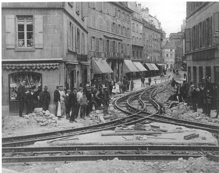
Pose des rails de la boucle des tramways à la rue de l'Hôpital à Neuchâtel, vers 1910.
