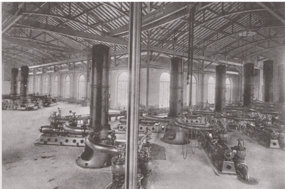
Pompes de la centrale à eau sous pression de la Coulouvrenière.
