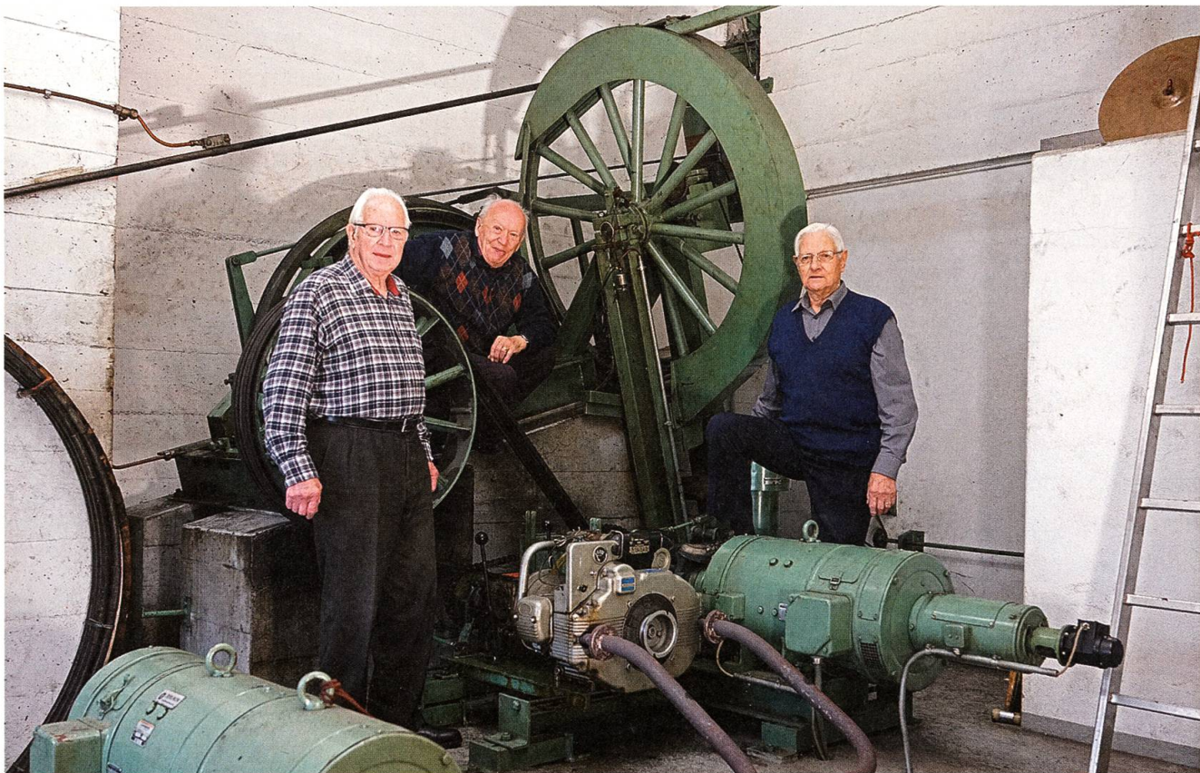
Im Maschinenraum der alten Anlage der Luftseilbahn Fellboden–Bannalpsee.
