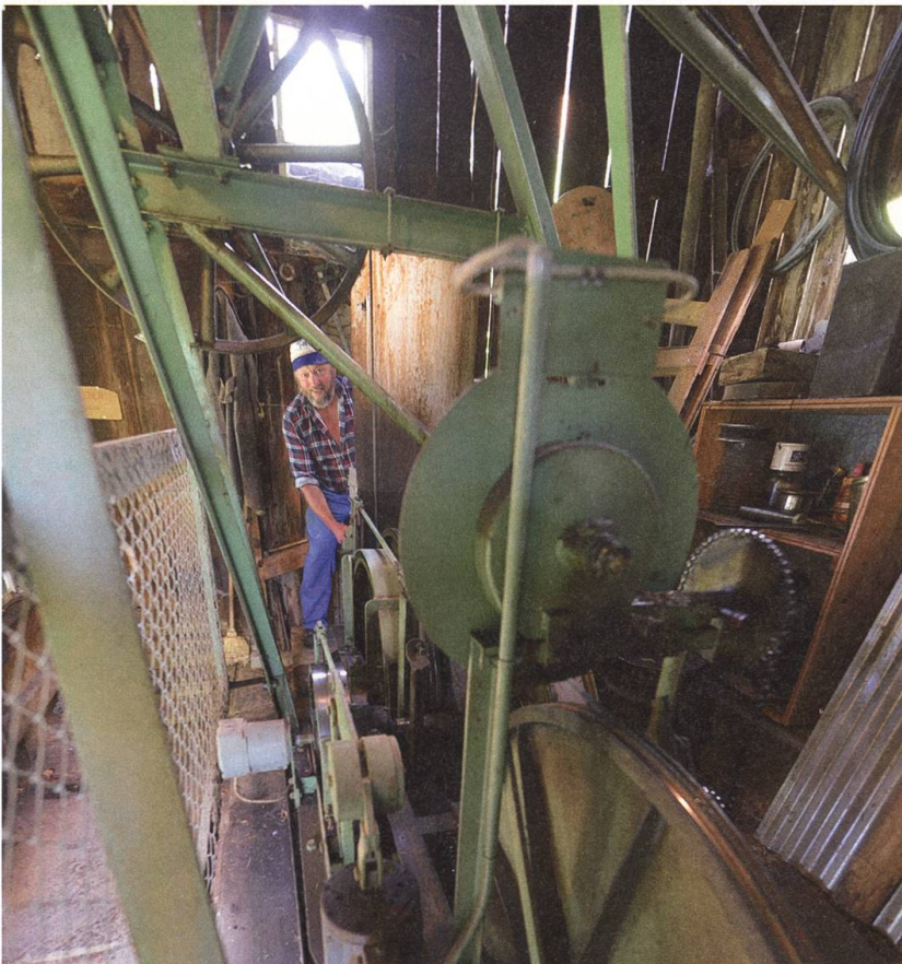
Walter Niederberger im Maschinenraum der Mettlen-Flüemattli-Bahn ...
