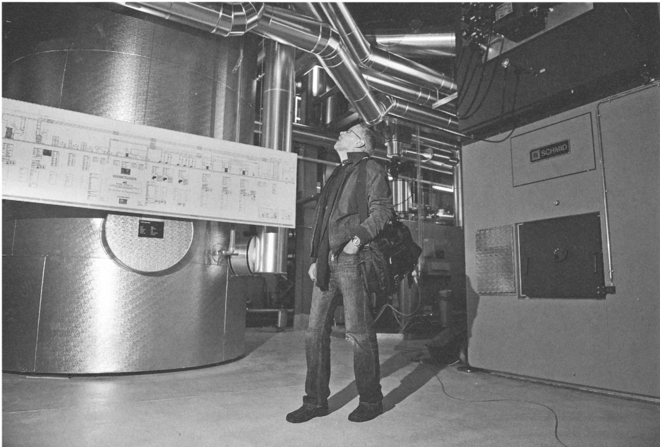
22.10. Peter Steiner, Verwaltungsratspräsident Heizverbund untere Kniri AG, in der Heizzentrale.
