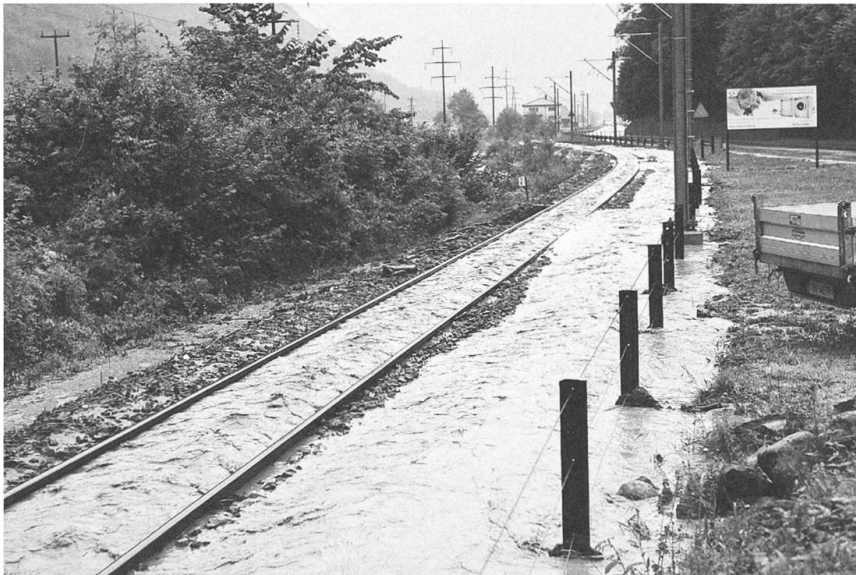
29.6. Schweres Gewitter im Engelbergertal: Bahn-Trasse verschüttet.
