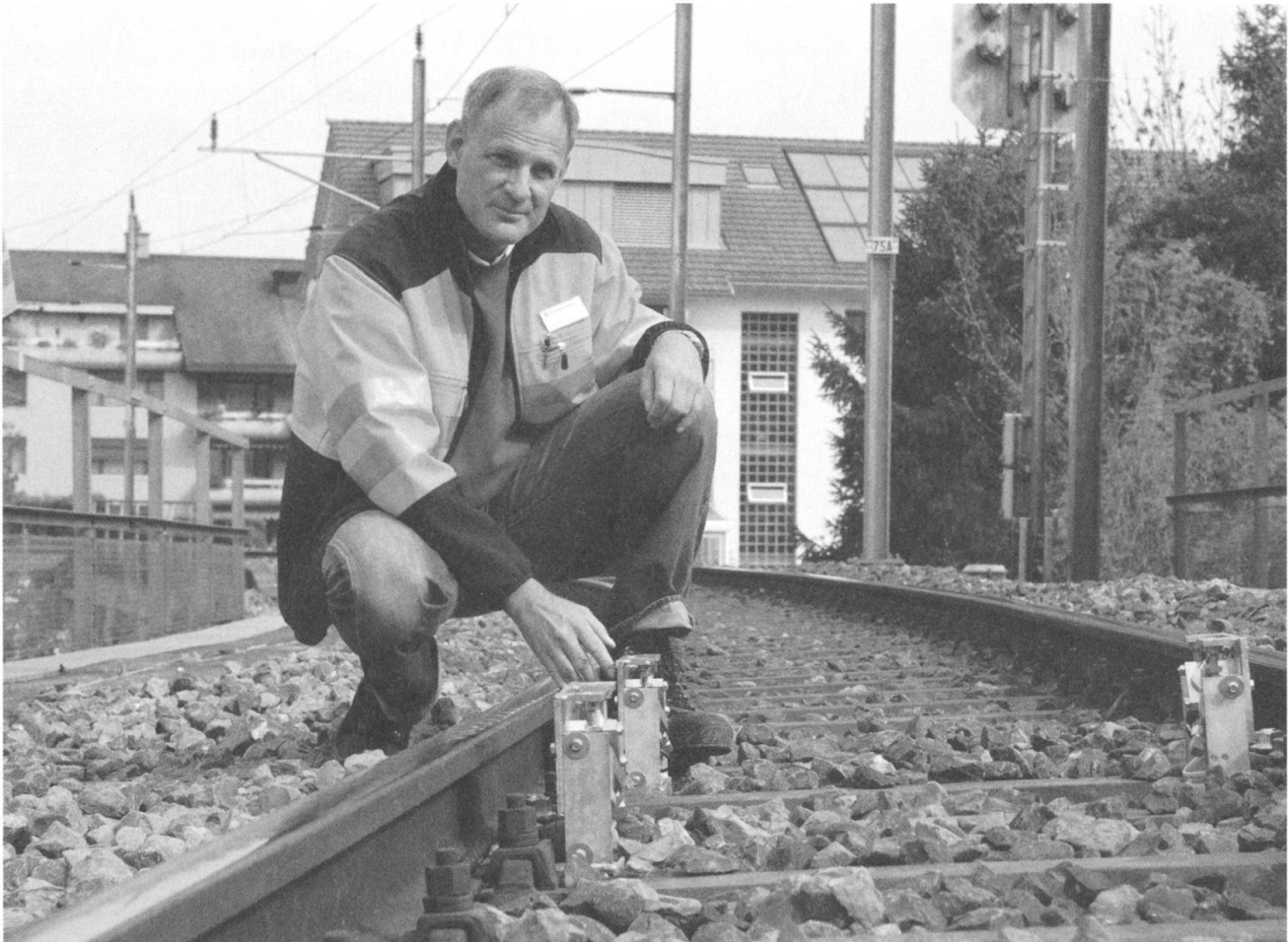
17.4. Martin Röthlisberger, Infrastrukturchef der Zentralbahn, zeigt die neue Kurvenschmieranlage.
