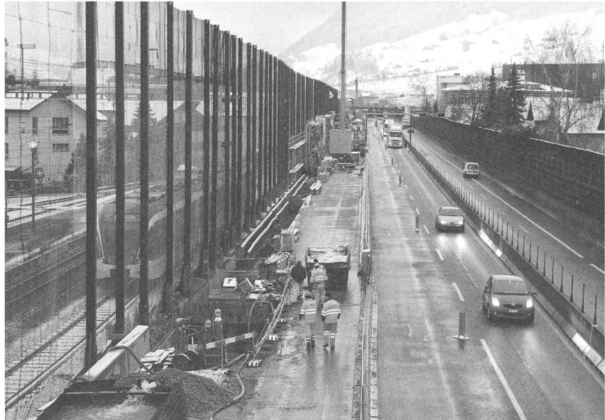
8.1. Lärmschutzgalerie Stansstad: Sorgen und Gefahren.
