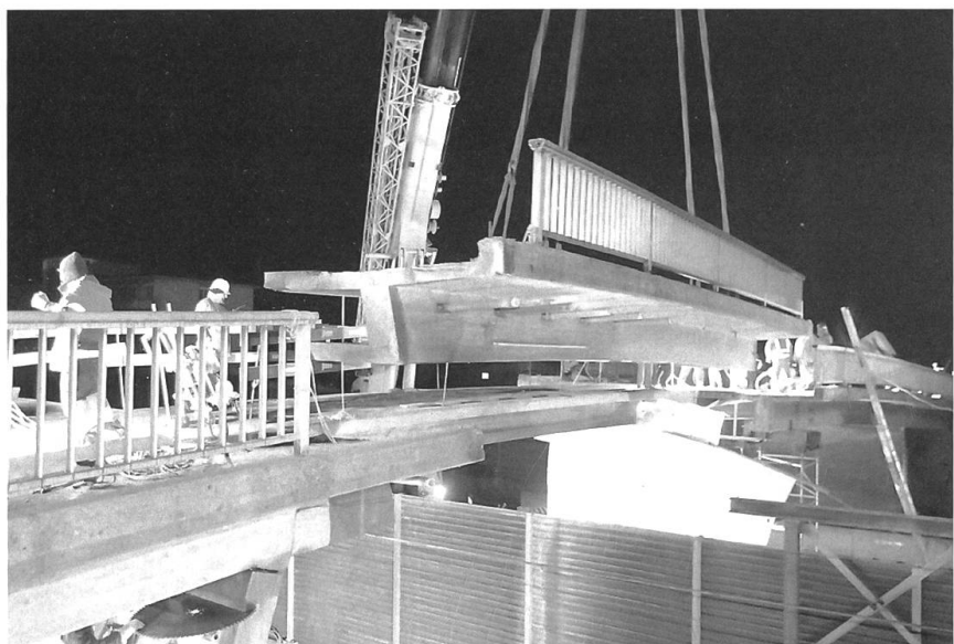
23.11. Brücke in Stücken weg.
