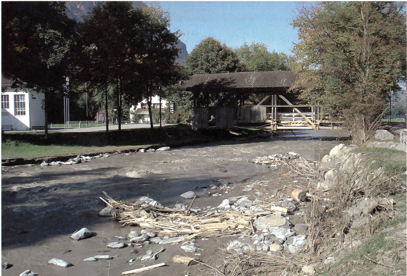
Bei der Brücke Oberau wurde das Tragwerk durch das Hochwasser zerstört.
