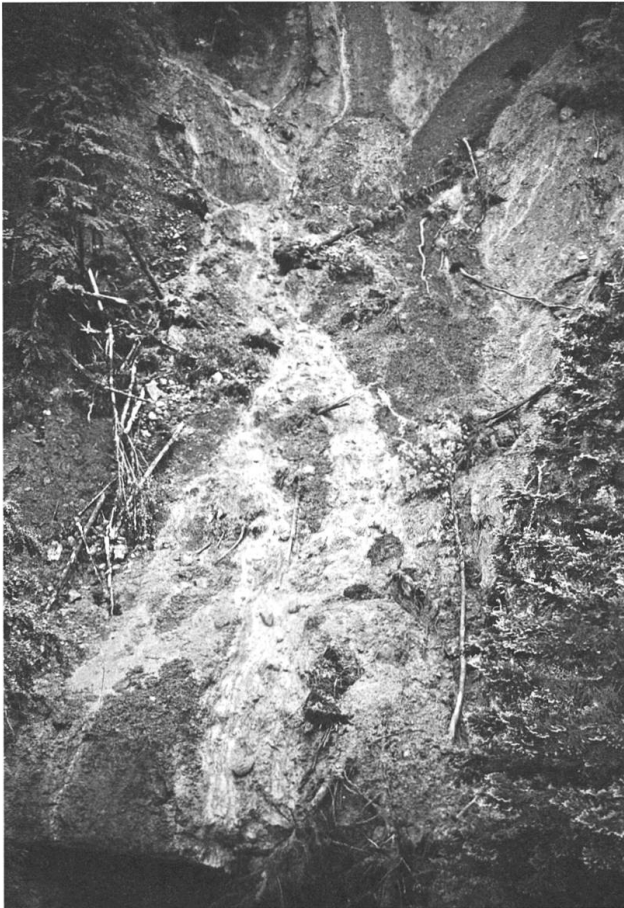
Überströmter Sammler und beschädigte Brückenplatte beim östlichen Arm des Hinter-Erlibaches (III) an der Werkstrasse 3 im Juni 1999.
