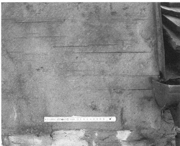
Stans, Winkelrieddenkmal. Schadensbefund: Rissbildungen am Sandstein.
