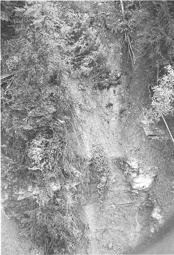
Pfingstmontag, 24. Mai 1999. Murgang einer der vielen Nachrutschungen fällt beim Kellbach über die Steilstufe zur Werkstrasse 3.
