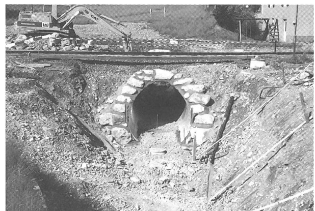
Im Zuge der Sanierung des Gleises und der Strasse in der Allmend in Dallenwil wurde ein Viehdurchlass eingebaut.
