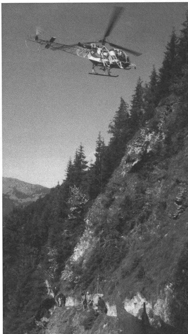
In dieser steilen Wand kann das Material für die Fassung des Wassers nur per Helikopter rentabel transportiert werden.
