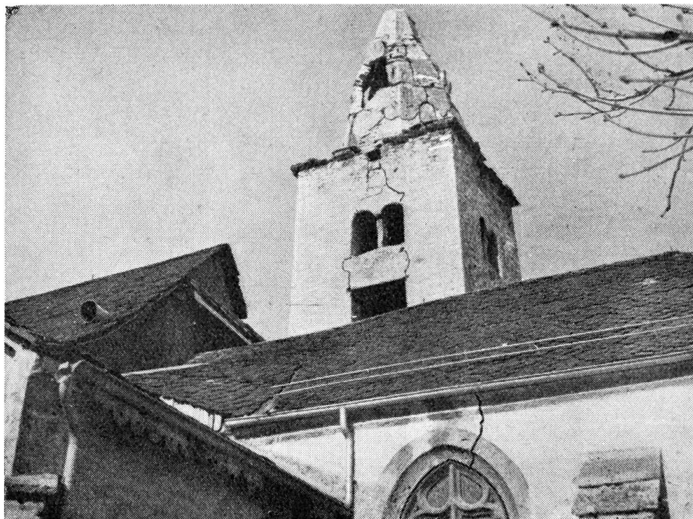
Zur Erdbebenkata- strophe im Wallis Die arg beschädigte Kirche von Sierre.
