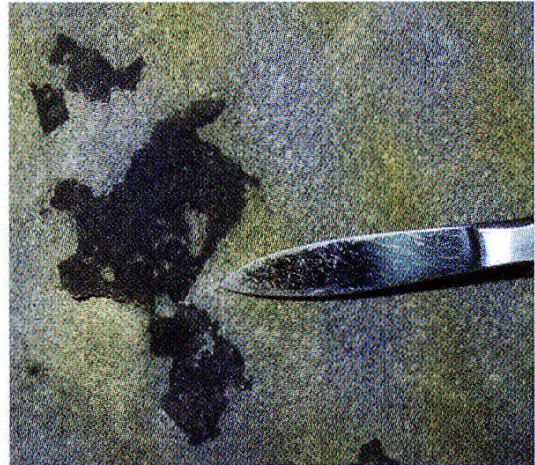
Abb. 6: Durch chemische Verwitterung bzw. Auflösung zurückgewitterte Sandsteinoberfläche mit Relikten einer verschmutzten Gipskruste. (Foto: A. Küng, 28. 4. 2006)
