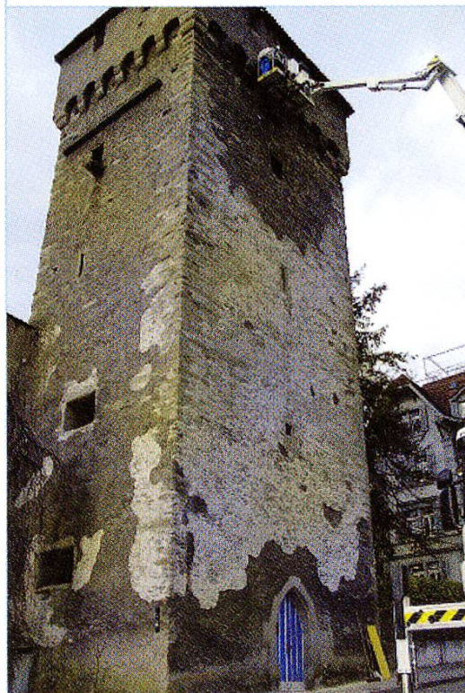
Abb. 4: Nordfassade des Allenwindenturms nach Abfallen des zementhaltigen Fassadenputzes im Frühjahr 2003. (Foto: A. Küng, 7. 4. 2003)
