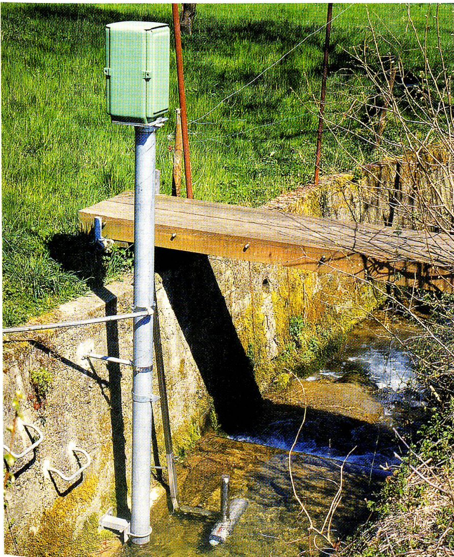
Abb. 24: Abflussmengenmessstation des Mülibaches bei Retschwil. Linnigraf und Probenahmengerät für Chemie, in Betrieb seit 1985.
