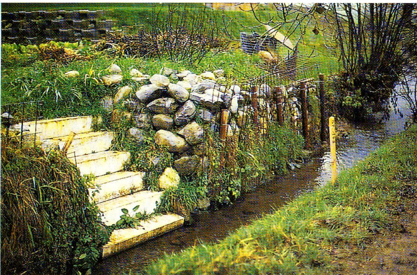
Abb. 4: Stägbach stark beeinträchtigt durch künstliche Uferverbauungen, steile Uferböschung und Aufschüttungen.
