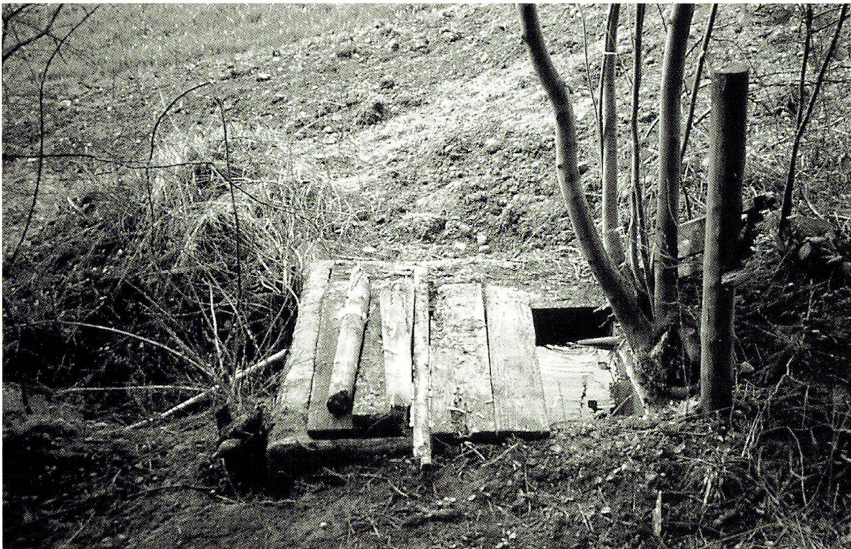
Abb. 5: Alte, private Brunnenstube östlich Zollhus. Das Quellwasser ist untief gefasst und die Brunnenstube mit einer morschen Holzabdeckung versehen. Solches Quellwasser erfüllt die Anforderungen an die bakteriologische Reinheit nicht.
