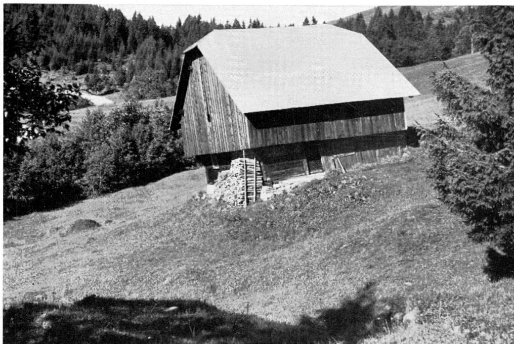
Abb. 4 Schiefstehender Heuschober im Rutschgebiet bei Egghütten
