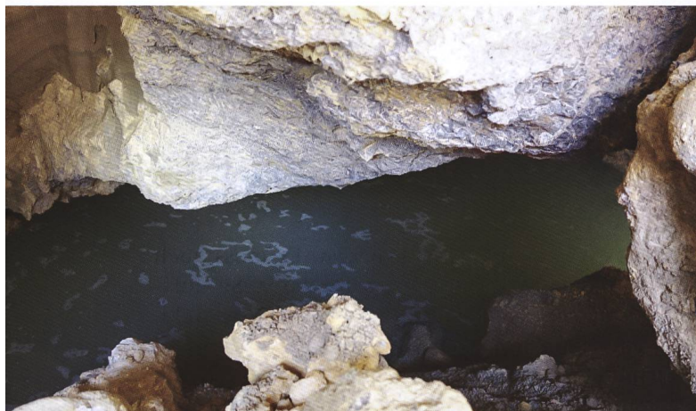
Abb. 7: Aufgebrochener Karsthohlraum in der gipsführenden Raibler-Rauhewacke aus der Trias. Baustelle Kläranlage Furnatsch bei S-chanf (Foto: Th. Rüegg).
