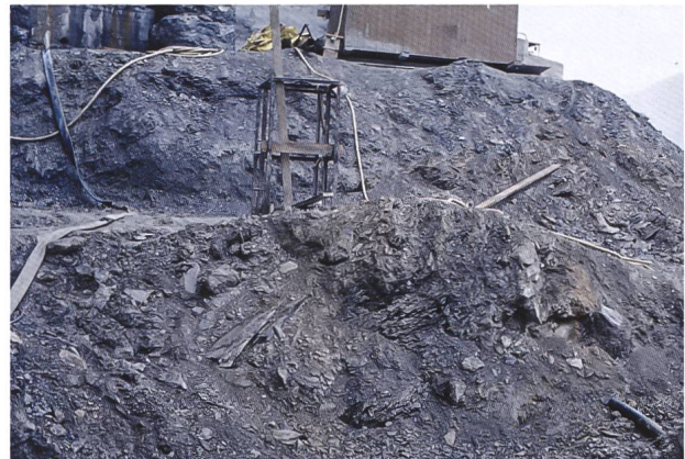
Abb. 3: Baugrube Chesa Corviglia (Baubeginn 1980), Aushub in der chaotischen, verflochtenen Sturzmasse (Foto: Ch. Schlüchter).
