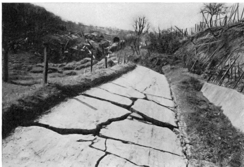
Abbildung 37. Untere Teilrutschung. Weinhagstrasse, durch Drehbewegung der «Depressions»-Scholle bergwärts geneigt. Strasse durch Verschiebung gegen «Doppelwohnhaus»-Scholle und gegen den auf derselben vorstossenden Wulst der mittleren Teilrutschung abgeschnitten. Photo JECK, Basel, 8. April 1952, nachmittags
