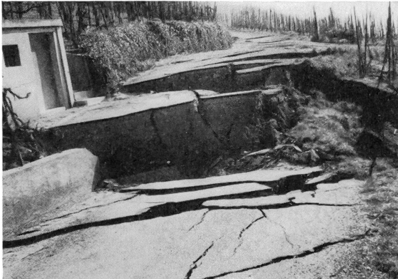
Abbildung 28. Abriss Ost der mittleren Teilrutschung. Südöstliche, seitliche Abriss- und Verschiebungsspalte bei Beginn der Rutschung. Gerätehäuschen (links auf dem Bilde) noch nicht zerstört. Photo DIERKS, 8. April 1952, vormittags
