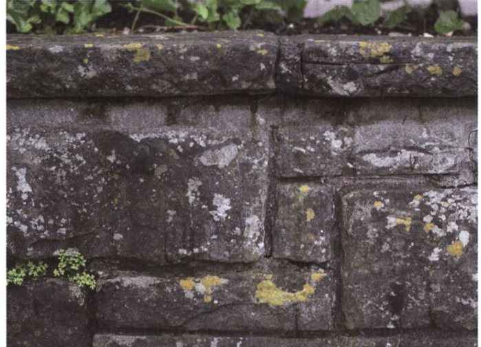
Stützmauer mit Krustenflechten, unter anderem der orange-farbenen Caloplaca velana
