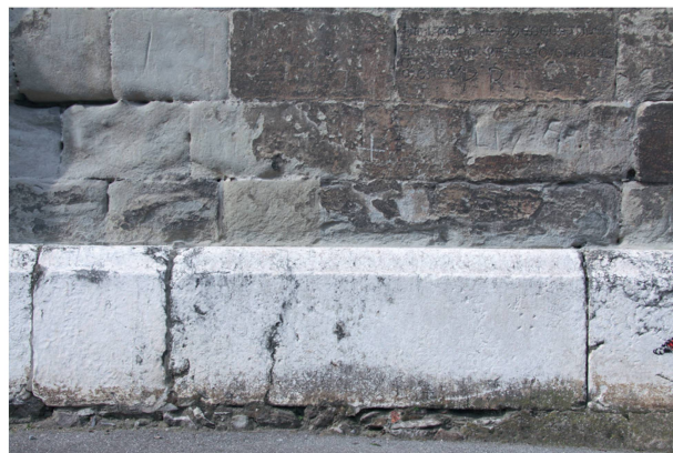
1 Cathédrale de Lausanne, dégradation de la molasse au niveau du chœur (Photo Bureau Christophe Amsler).
