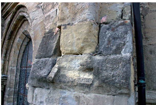
1,2 Cathédrale de Lausanne, dégradation de la molasse au niveau du chœur (Photo Bureau Christophe Amsler).
