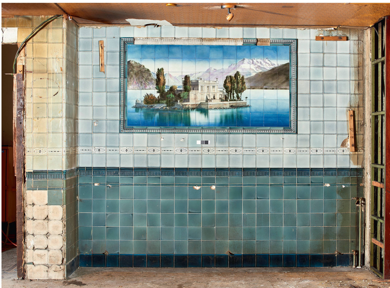
4 Paroi sud, l'île de Salagnon. La finesse de la cloison portant le décor explique peut-être la perte de quelques carreaux du cadre (© Rémy Gindroz, photographe).
