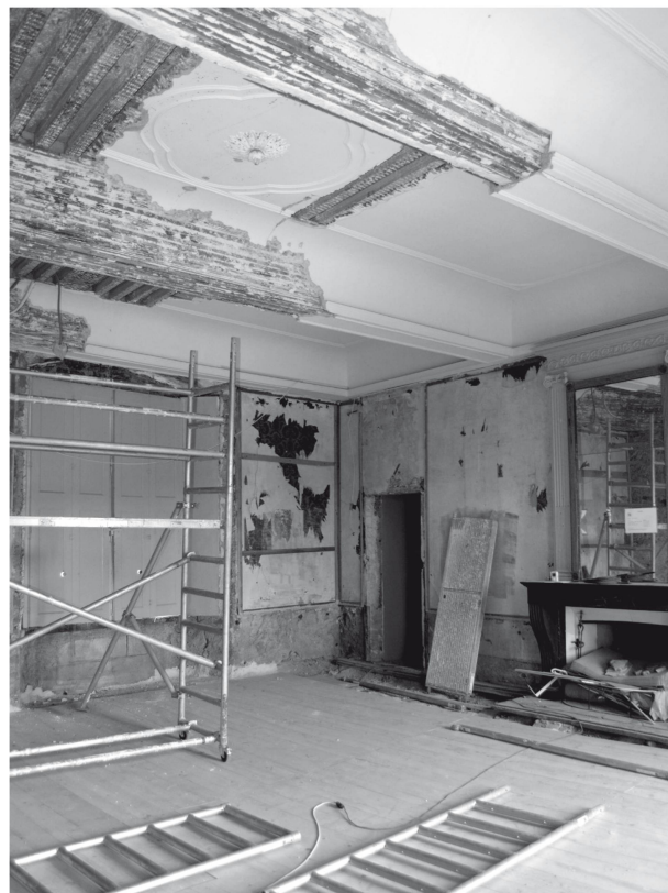
2 Grand Salon du château de La Sarraz, état après le démontage des boiseries et du plafond (Photo D. Decrausaz, août 2012).
