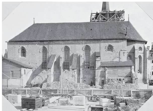
12 Saint-François de Lausanne, flanc sud, photographié vers 1899 (ACV, AMH D 35, Rapport de Th. Van Muyden, 24 mai 1899).
