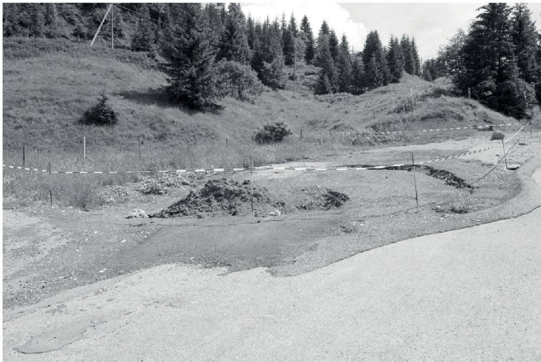
Figure 6.–Doline se développant le long de la route du col du Pillon (juin, 2009).
