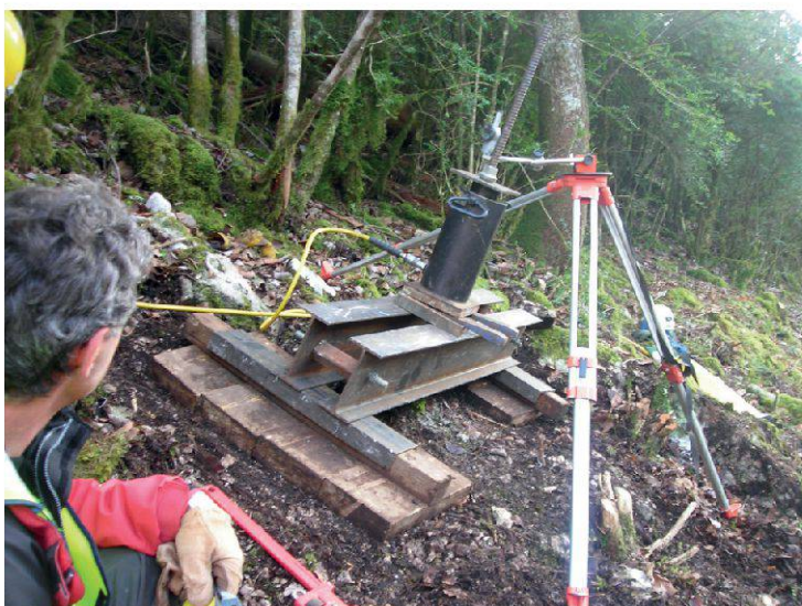
Figure 15.—Test de traction sur ancrage de filet 3000 kJ (Sylans); photo BG / Hugues Foltzer.
