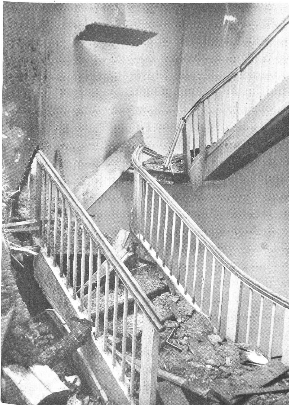
Naturhistorisches Museum Schaffhausen. phot. W. Schraner Zerstörter Treppenaufgang, wodurch der Zutritt zum dritten Stockwerk schon bald nach dem Brandbeginn verunmöglicht war.
