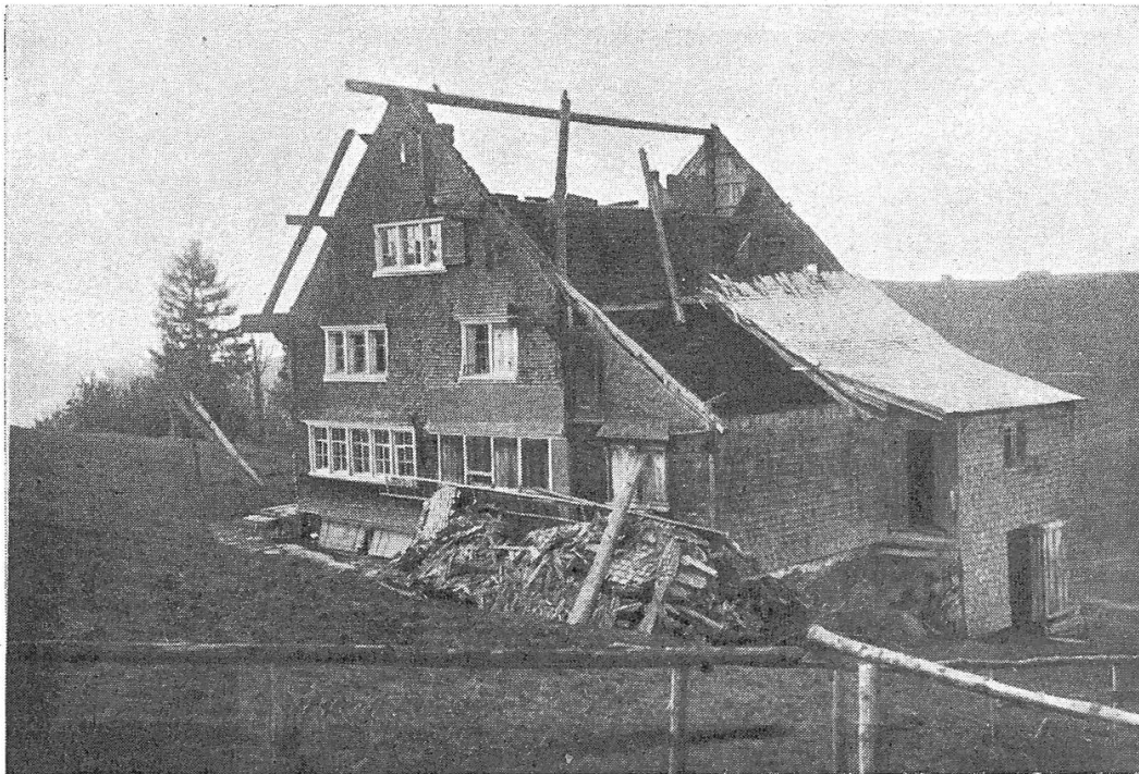
Abb. 14. Sturmverheerung in Eggersriet (St. Gallen) 1919.
