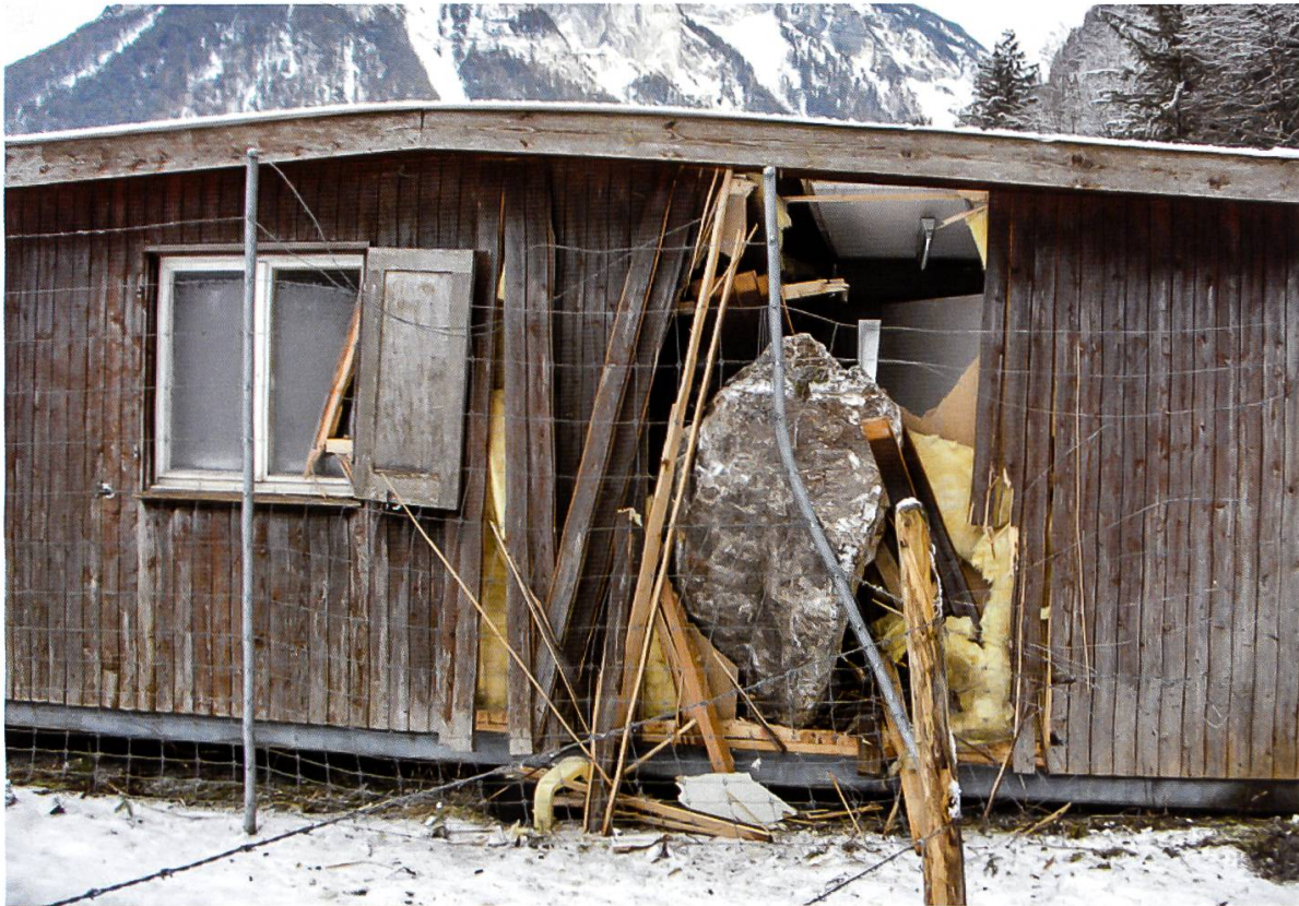
Abbildung 11: Starke Temperaturwechsel zwischen -10^{\circ}\text{C} und +5^{\circ}\text{C} lösten im Januar 2009 in einer Felswand bei Innertkirchen einen Abbruch von rund 300\text{m}^3 aus, wobei ein Block eine Baracke stark beschädigte.
