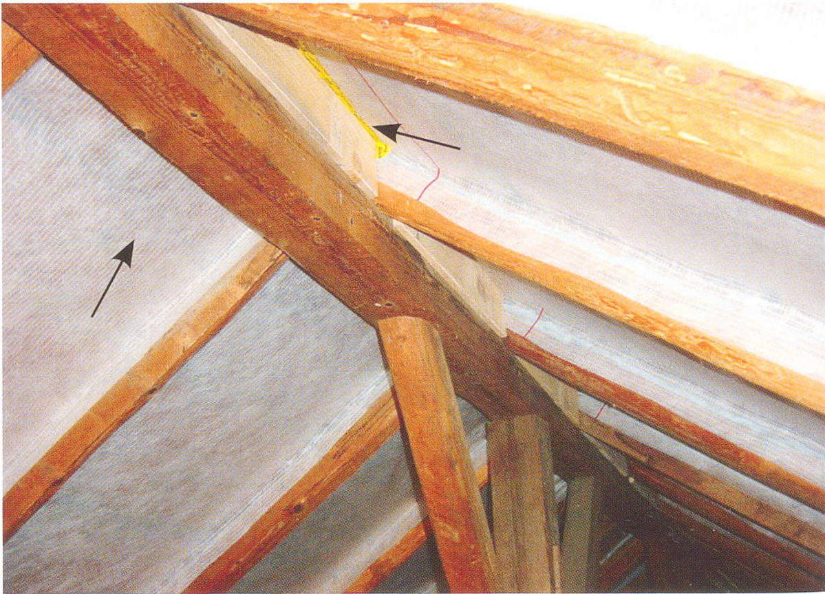
Figure 23: Doublure du lambrissage au moyen d'une bâche et obstruction des fentes des planches. (Photo: BIF/Ch. Bossard)
