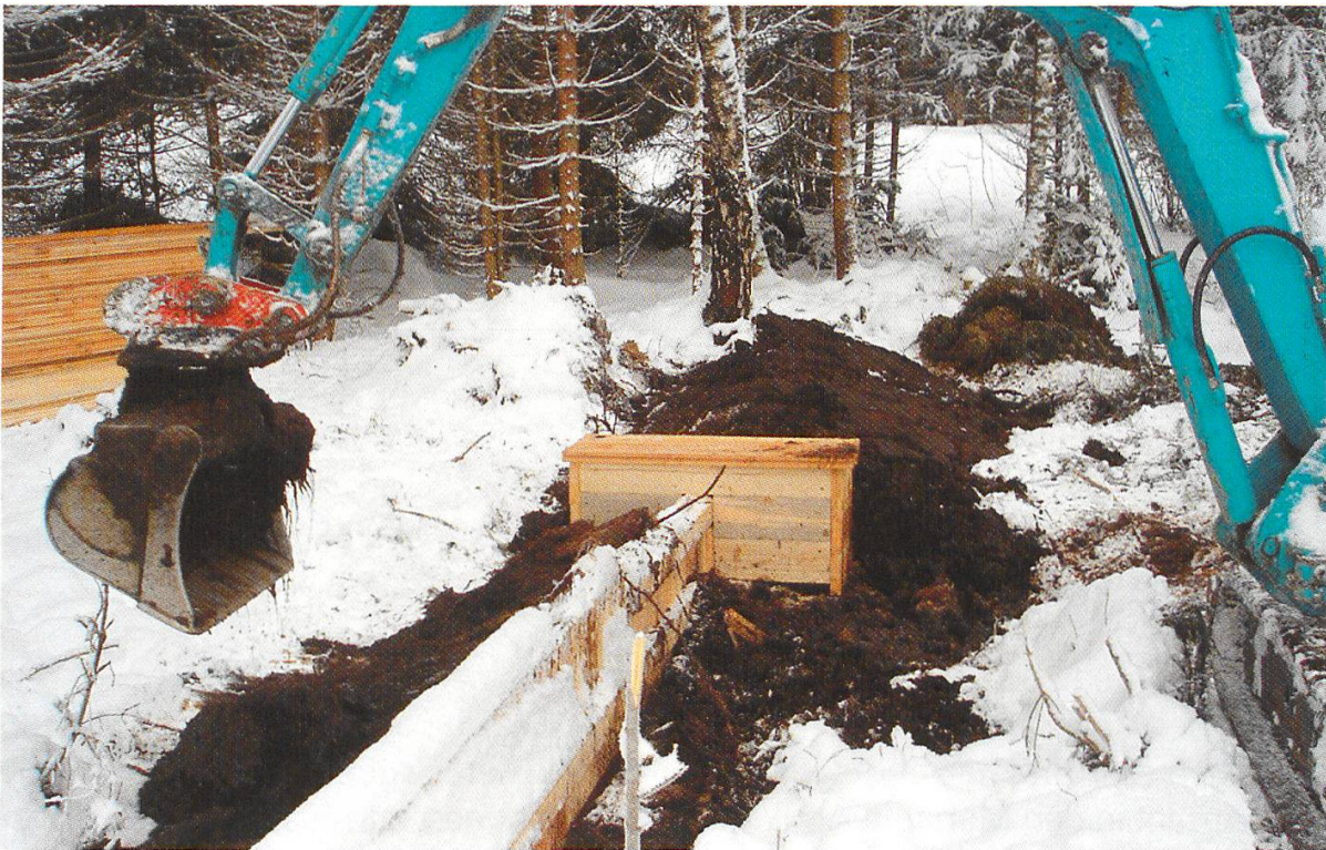
Abbildung 6: Kontrollschacht für regulierbaren Wasserstand. (Foto: Naturschutzinspektorat, Dezember 2005)
