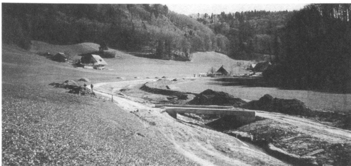
Abbildung 9: Verteilt auf mehrere Lose wurden die Bauarbeiten innerhalb kurzer Zeit realisiert. Das Aushubmaterial wurde zum Bau der Polderdämme verwendet, wodurch längere Transportdistanzen und Deponien entfielen. (Foto P. Augustin, Februar 1998)
