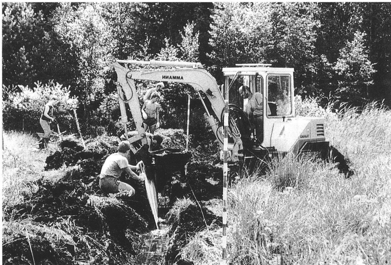
Abbildung 2: Einbau der Holzplatten für die Dämme in Les Pontins mit Moorraupe und Handbeihilfe durch Lehrlinge. (Foto H. Garo, 2. August 1988)
