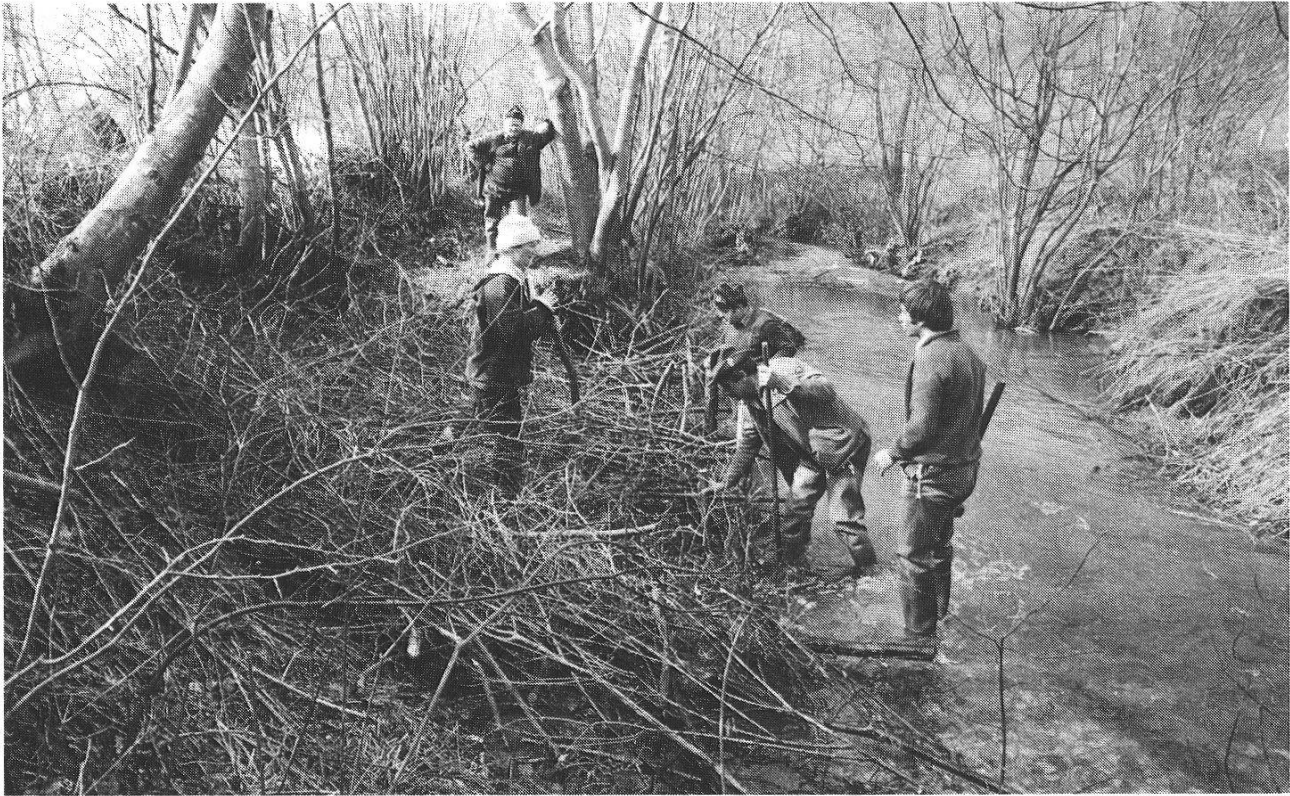
Abbildung 3: Beispiel 1: die Kursteilnehmer erstellen einen Gitterbuschbau, der den ganzen Kolk ausfüllt. (Foto M. Cloetta)
