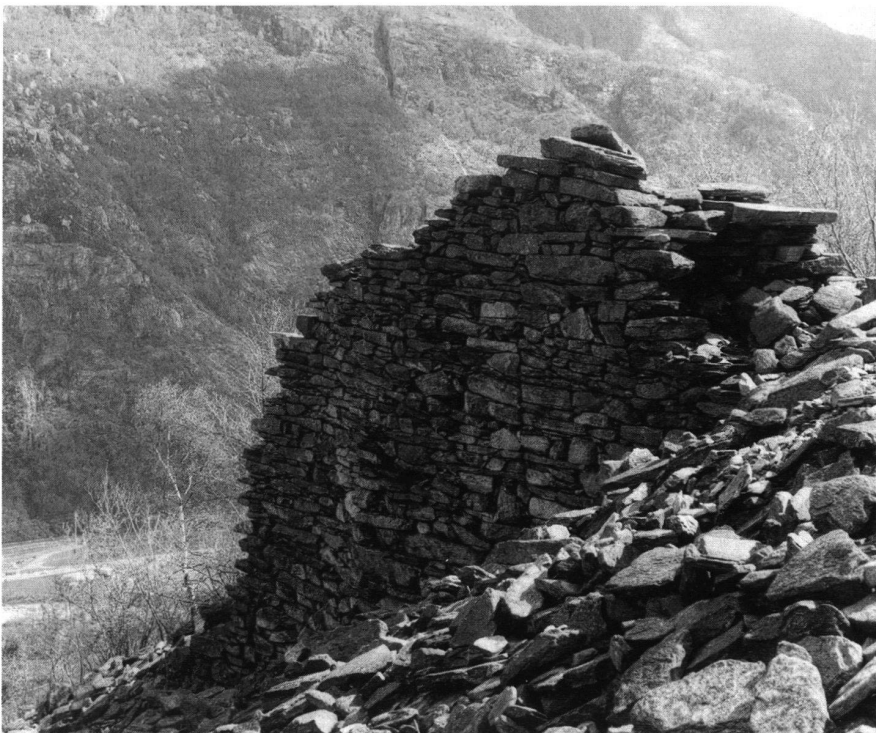
7: Caslasc. Orsino-Mauer (M1–M2), Ansicht von Westen. An dieser Stelle erreicht die Mauer M1 eindrucksvolle 7,5 m in der Höhe (senkrecht gemessen).
