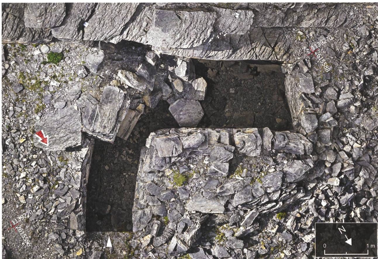
9: Alte Gemmi. Relevé orthophotographique du bâtiment aménagé au col. Une partie du mur amont s'est effondrée à l'intérieur de l'édifice. Éch. 1:50.
