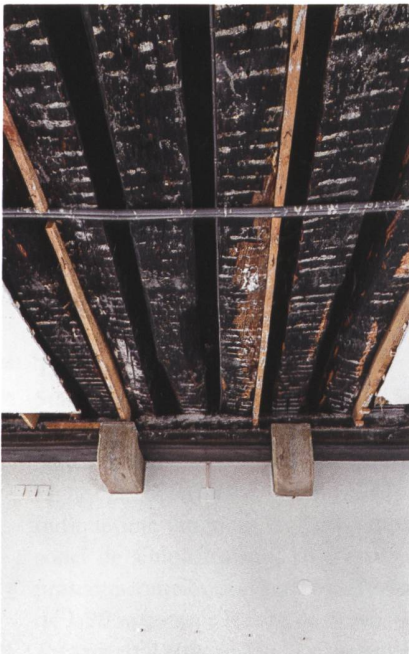
Die erhaltene Bodenbalkenlage des hölzernen Obergadens auf dem Palas. Die Balken wurden gemäss dendrochronologischer Datierung im Herbst/Winter 1372/1273 geschlagen. (Foto: ADB, Marco Amstutz).
