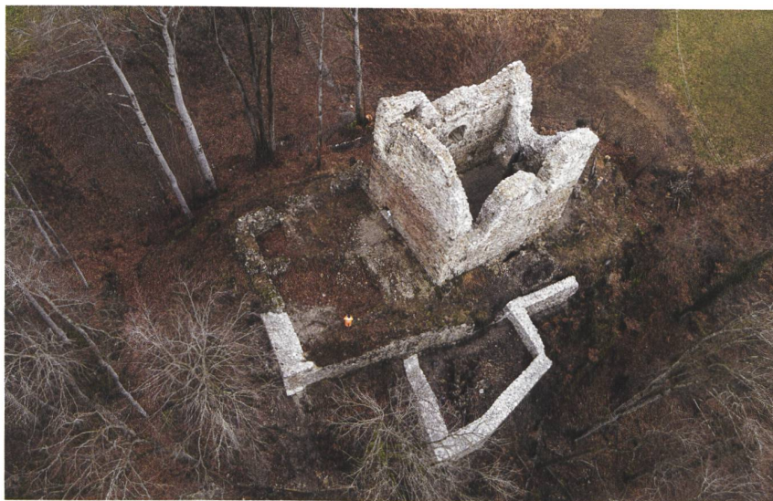
Die Ruine im Überblick nach Abschluss der Sanierung im Februar 2024. Drohnenaufnahme mit Blick nach Nordosten. Deutlich sichtbar sind der Turm, der Burghof West, die südseitige Ringmauer und südlich davon der Zwinger oder das Torhaus. Blick nach Nordosten. (Foto: ADB).
