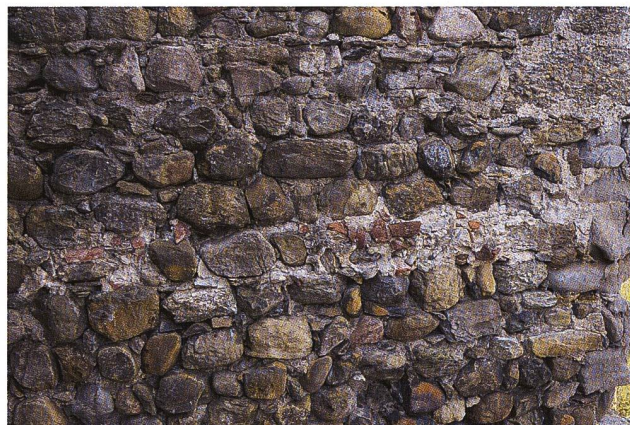
25: Häggenschwil SG, Ruine Alt Ramschwag. Mit Klosterziegeln durchsetzte Mörtelbraue 6.2 in der Aussenfassade der Mauer M11 des Turms. Vermutlich diente sie zur Abdichtung einer Fuge zwischen der rauen Maueroberfläche und einem an den Turm angelehnten Dach. Aufnahme 2022, von Osten.
