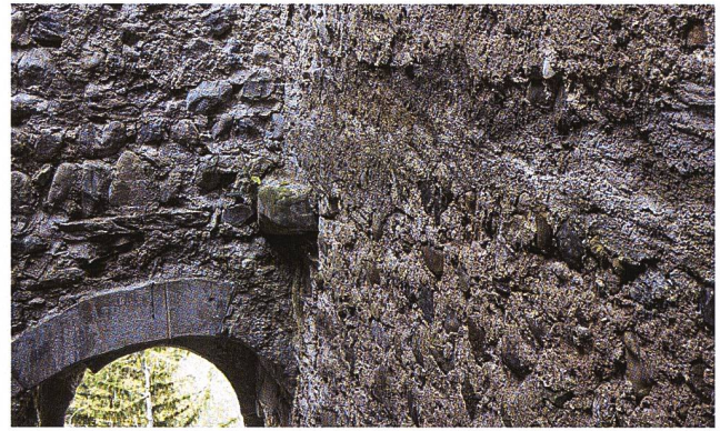
23: Häggenschwil SG, Ruine Alt Ramschwag, Turm. Der um 1930 mit Zementmörtel ausgeworfene Streifen 8.2 in der Innenfassade der Mauer M10 entspricht in etwa der Bauhöhe des Fussbodens im 2. Obergeschoss des Turms. Im Hintergrund zu sehen sind das um 1930 fälschlicherweise als Stich- statt als Rundbogen rekonstruierte Gewölbe über dem Hocheingang 9.2 und der Kragstein 7.7. Aufnahme 2024, von Osten.
