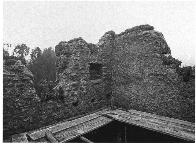
24: Häggenschwil SG, Ruine Alt Ramschwag. Turm. Frisch saniertes Mauerwerk in der Ecke M12/M9 mit den Öffnungen 12.3, 12.2 und 9.6 (v.l.n.r.). Die drei in der Mauer M12 vorhandenen Balkenlöcher sind Überbleibsel der Fussbodenkonstruktion des 4. Obergeschosses. Beachtenswert sind die Rasenziegel, die man um 1930 auf den Mauerkronen auflegte. Aufnahme um 1930, von Norden.
