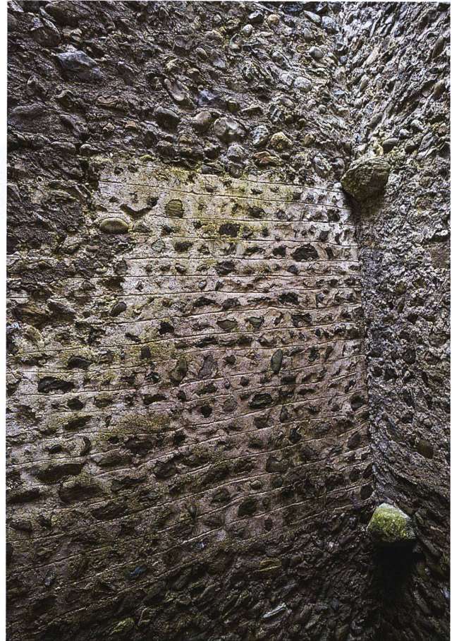
22: Häggenschwil SG, Ruine Alt Ramschwag, Turm. Im 1. Obergeschoss auf der Rückseite der Schildmauer aufgetragener Rasa-Pietra-Verputz mit Fugenstrich (10.1). Der Putz ist oberflächlich leicht brandgerötet. Gut zu sehen ist, dass die Oberkanten der in der Mauer M9 eingesetzten Kragsteine, auf denen die Fussböden des 1. und des 2. Obergeschosses aufgelegt waren, nicht mit den Höhen des unteren und des oberen Saums des Verputzes in Verbindung gebracht werden können. Aufnahme 2024, von Norden.
