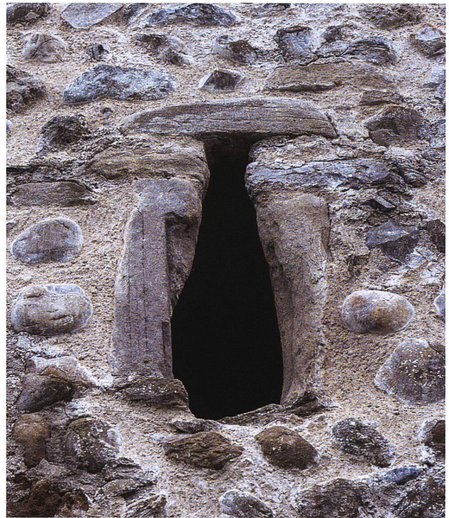
31: Häggenschwil SG, Ruine Alt Ramschwag. Turm. Schartenfenster 9.1 in der Mauer M9 des Erdgeschosses. Die beiden in der unteren Hälfte verbauten Sandsteinspolien und die Fensterbank sind von aussen her beschädigt. Möglicherweise wollte man sich so Zugang zum Turminneren verschaffen. Aufnahme 2024, von Südwesten.
