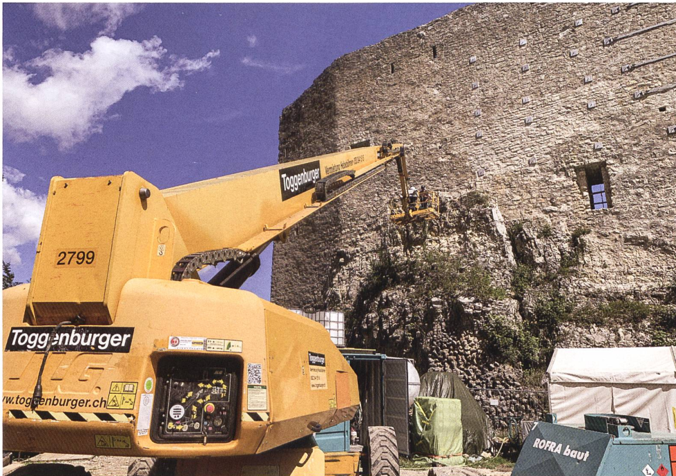
37: Mittels einer weitreichenden Hebebühne wird 2021 die Südfassade der Schildmauer nach Schäden inspiziert. Das volle Ausmass der Schäden trat dann erst im Folgejahr bei der Sanierung der Mauer zu Tage.
