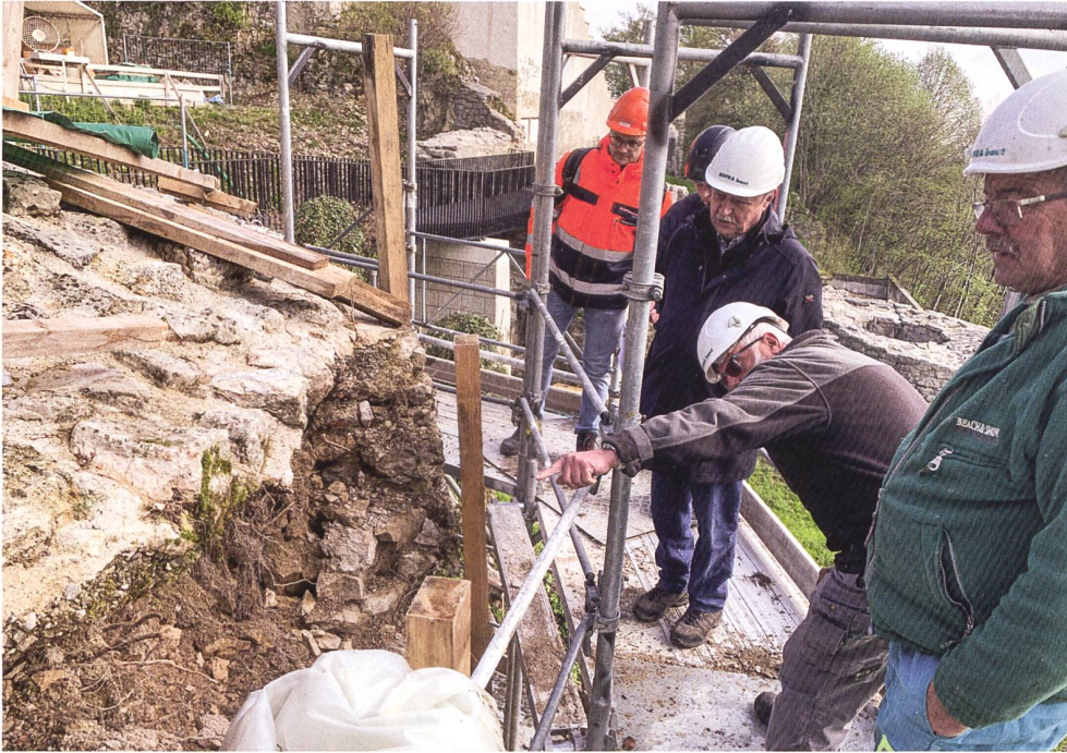
44: Überraschungen bis zuletzt: Bauführer Rolf Frei zeigt dem Bundesexperten Daniel Gutscher die nur mit losem Schutt unterfüllte Kronenabdeckung der Barbakane.
