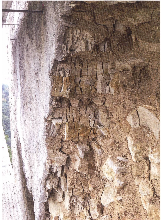
23: Die mit stark zementhaltigem Mörtel verfugte und so durch Frost vollständig zerstörte und abgelöste Mauerschale aus Hauptrogensteinen an der Südfassade der Schildmauer.
