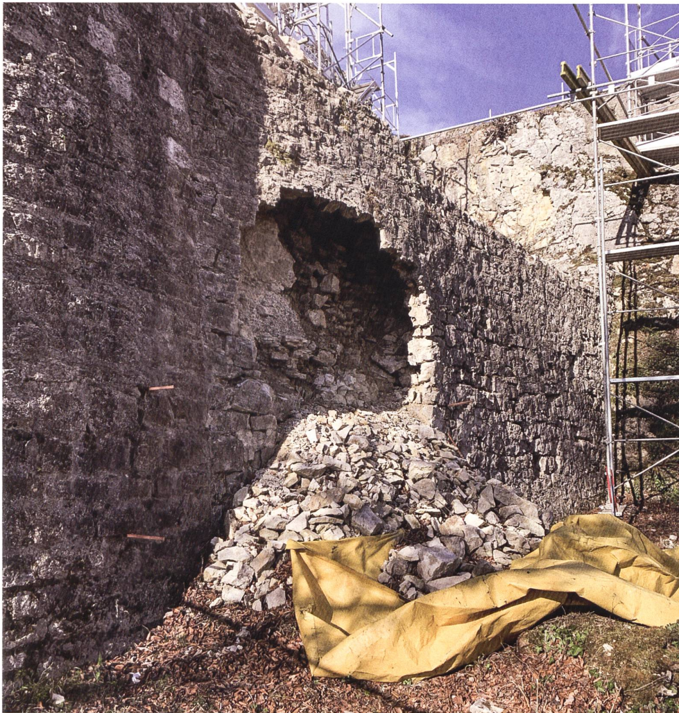
29: Die nördliche Abschlussmauer des Brunnenhauses vor der Sanierung mit einer aufgebrochenen Mauerschalenablösung infolge eingesickerten und gefrorenen Meteorwassers.
