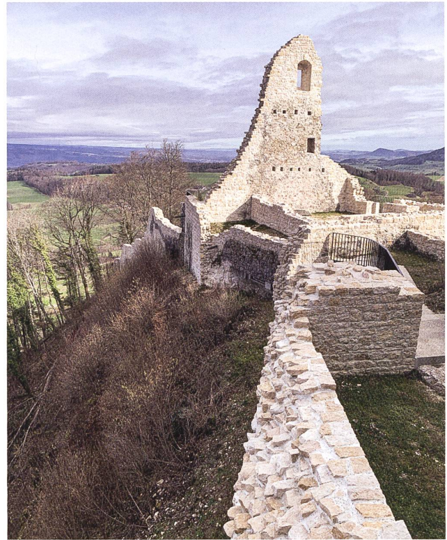
16: Für eine bessere Wahrnehmung des Befundes: Im Zuge der Sanierung neu ausgebildete Mauerzüge sollen den Ausbruch im Grundriss an der westlichen Flanke der Oberburg stärker betonen.
