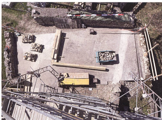
35: Aufgetaucht aus dem Untergrund: der für die Abdichtung der Betondecke wieder freigelegte Artilleriebeobachtungsposten aus dem Zweiten Weltkrieg in der Oberburg.
