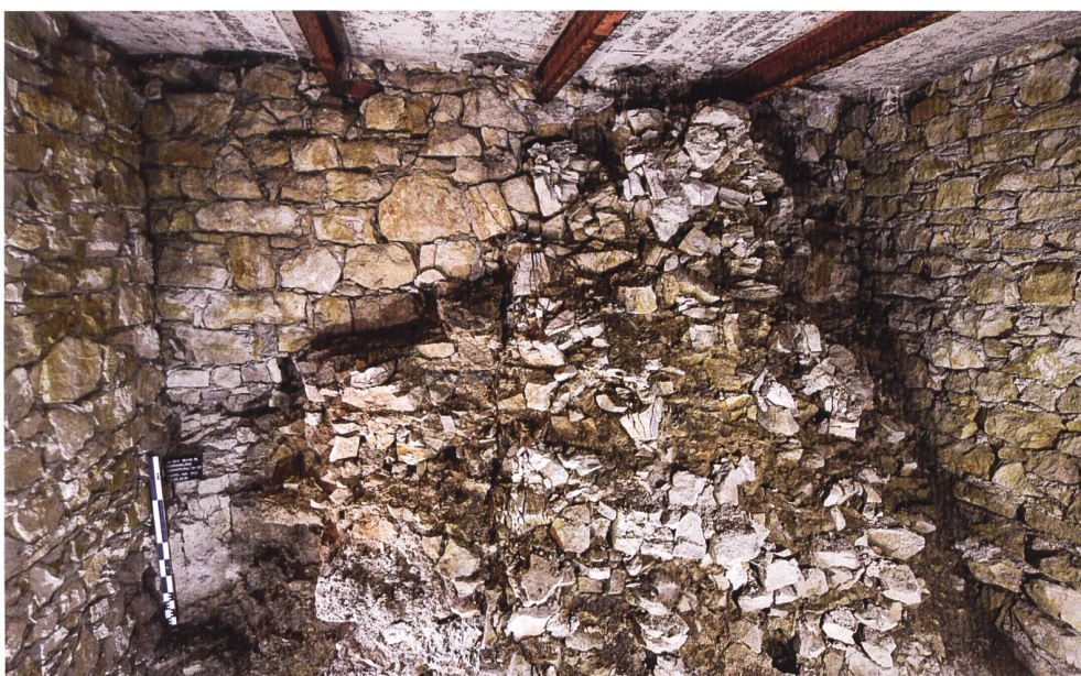
59: Mauerpfeiler im Hohlraum unter dem Pfisterhaus. Gut erkennbare, mit Anzug verlaufende Mauerfuge zwischen der verputzten, frostgeschädigten Mauerschale des älteren Mauerpfeilers (rechts) und der anstossenden Ummauerung des jüngeren Sockelmauerwerks mit vermauerten Steinen aus Quelltuff (links). Blick gegen Nordwesten.
