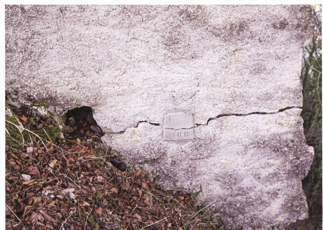
26: Ein im Jahre 2011 angebrachtes Zementsiegel an der Basis der Ringmauer (M1) im Unteren Burghof Nord wies bereits nach fünf Jahren Risse auf, welche auf die geologische Instabilität des Baugrundes zurückzuführen waren.
