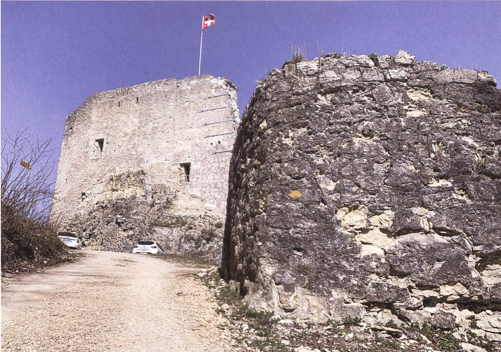
6: Die Ruhe vor dem Sturm – die Farnsburg kurz vor der aktuellen Sanierung. Rechts im Vordergrund die Barbakane mit den für Hauptrogenstein typischen Frostschäden an der Fassade.
