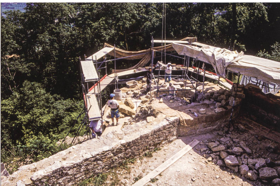
73: Der Bettlerturm (M17) wird während der Sanierung 2002–2003 neu aufgebaut. Mitarbeitende der Firma ROFRA Bau AG bei der Arbeit. Blick gegen Süden.
