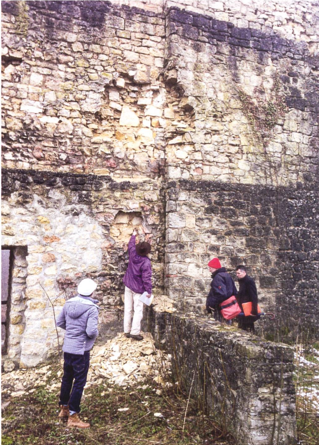
74: Begutachtung der Schäden an der Nordwand der Schildmauer (M2) unter anderem durch den Burgenspezialisten Jakob Obrecht (2. v. r.) vor der Notsicherung 2013.
