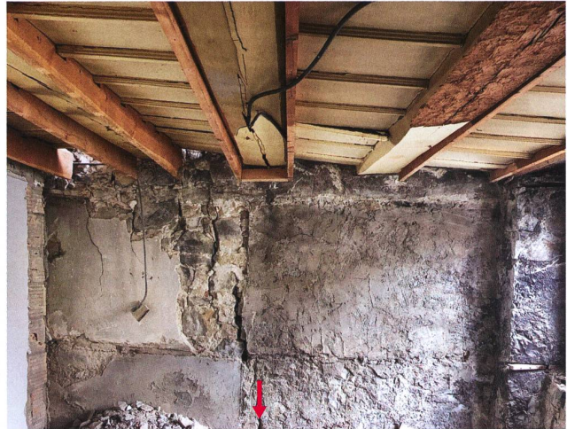
10: Der Anbau von 1690 hat sich im Bereich des Grabens gesenkt, was sich in der schrägen Decke zeigt. Die Risse in der Nordmauer (Pfeil) markieren den Verlauf der älteren Umfassungsmauer.
