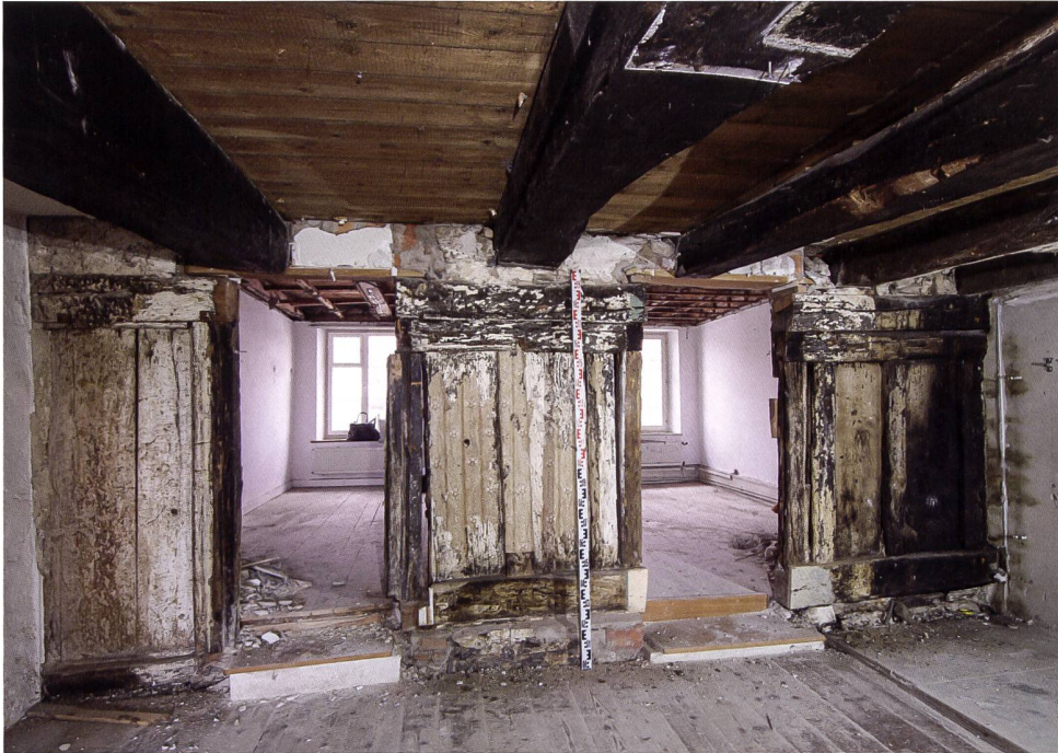
9: Im Obergeschoss des Wohnteils trennte eine russgeschwärzte Brettständerwand von 1515 (d) die Rauchküche von den Kammern ab. Foto 2018.
